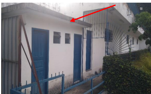
Foto 13 – A seta vermelha indica o volume do acréscimo em alvenaria dos sanitários a ser demolido
