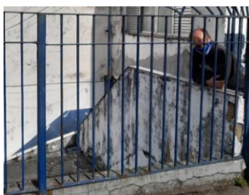
Foto 17 – Trincas e rachaduras junto a base do guarda corpo do pátio de recreação
