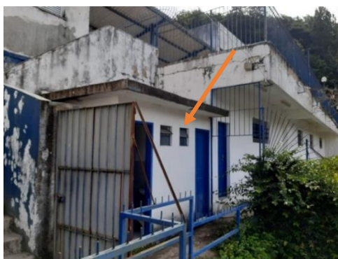
Foto 04 – Local dos sanitários a serem demolidos para implantação da plataforma elevatória de acesso ao 2º pavimento
