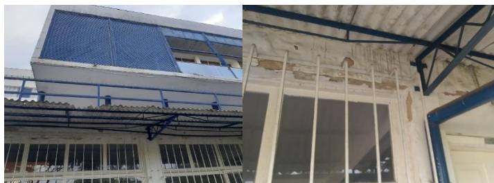
Fotos 15 e 16 – Detalhes da cobertura marquise no embasamento do prédio com necessidade de manutenção
