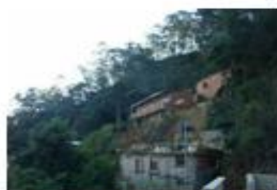
Foto 001 - Deficiência de drenagem e corte inadequado.
