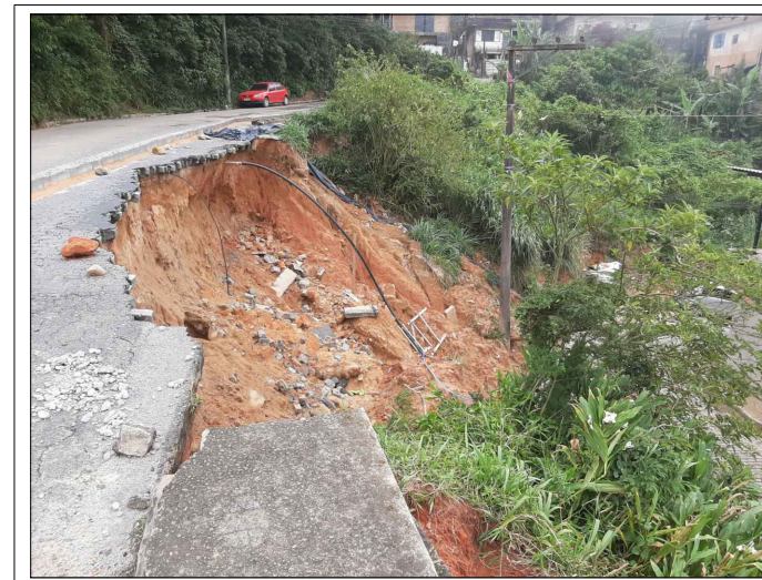
2 VISTA LATERAL DO ESCORREGAMENTO SEM ESCALA
