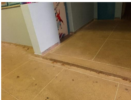
Fotos 07– Vista de um dos desníveis da circulação entre os blocos de salas de aula onde será considerado o nivelamento do piso
