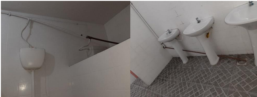
Fotos 22 e 23 – Detalhe das tubulações aparentes e improvisadas nos sanitários dos alunos
