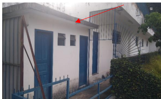
Foto 13 – A seta vermelha indica o volume do acréscimo em alvenaria dos sanitários a ser demolido
