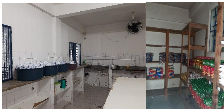
Fotos 20 e 21 – Vista da Cozinha existente com necessidade de ampliação e remodelação e vista da Despensa apresentando problemas de umidade, respectivamente
