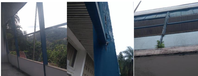
Fotos 08, 09 e 10 – Problemas de alagamento na varanda e madeiramento comprometido pela ação do tempo e ausência de manutenção
