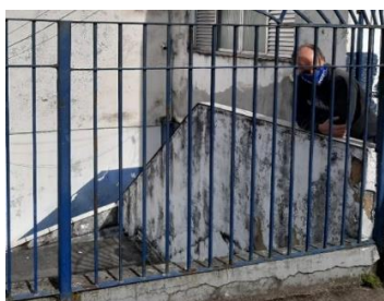
Foto 17 – Trincas e rachaduras junto a base do guarda corpo do pátio de recreação
